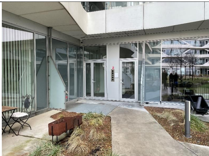
Beton belægning ud for nr. 3
