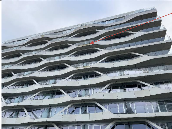
Facade mod vest. Flere plade fremstår med alger.
