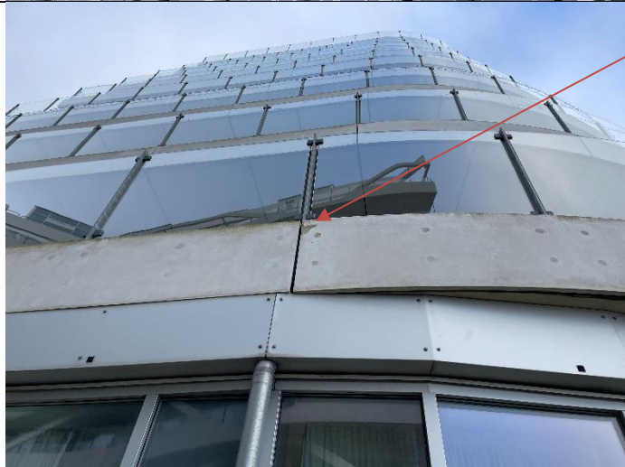
Facade mod nordvest. Fibercement plade er med begynd opløsning i hjørnet.
