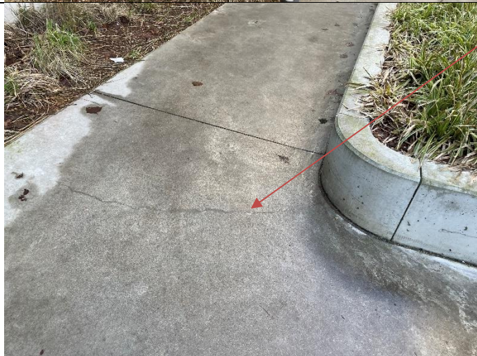
Revnet betonplade. Ved nr. 7 mod nord-øst.
