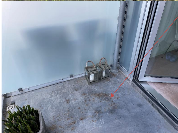
Altanplade med rust.
